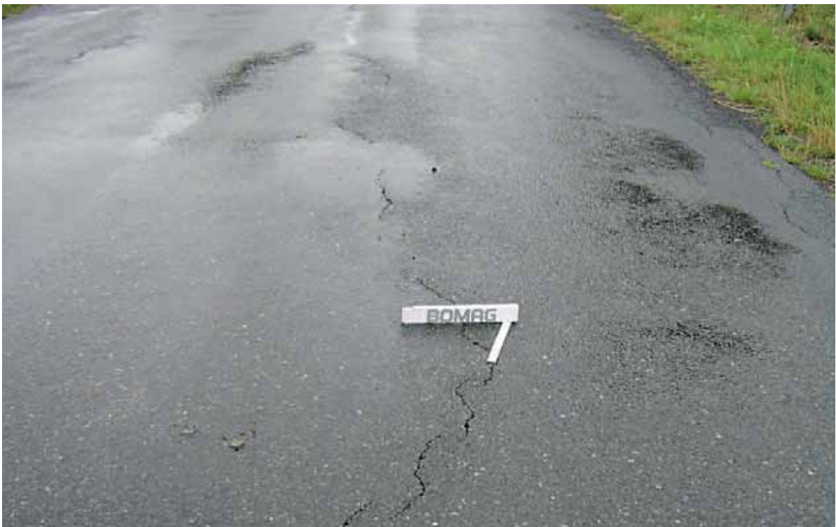
Zustand der Kreisstraße K 101 vor der Erneuerung.
